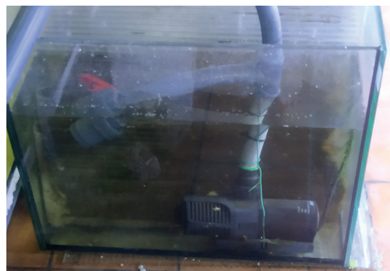
Bomba para la recirculación de agua / Water recycling pump
